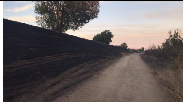
Burned levee post fire (Kathleen Colima).
